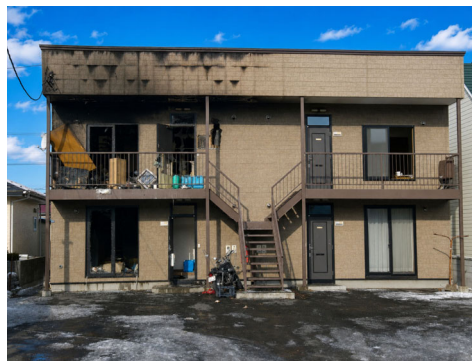
消火活動後の外観 被害状況(左側のみ)
