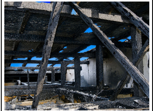
左側住戸の小屋裏 被害状況
